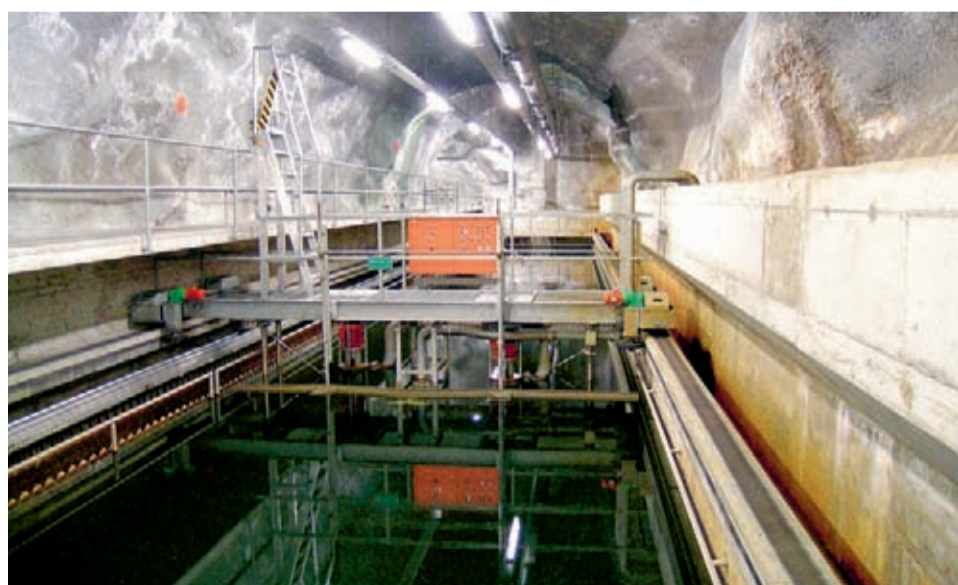
Kläranlage in der Felskaverne.
