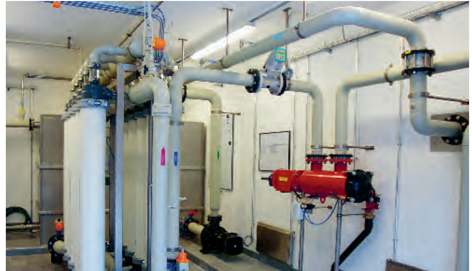
Das Reservoir Gandegg wurde im letzten Jahr ausgebaut und mit einer Ultrafiltrationsanlage ausgestattet.
