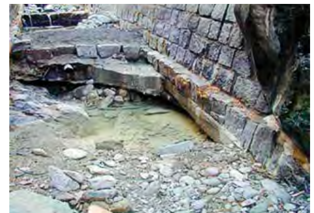
Unterspülte linke Ufermauer. Fels am rechten Ufer verhindert grösseren Kolk. Ufermauer wird auf Felsen fundiert.
