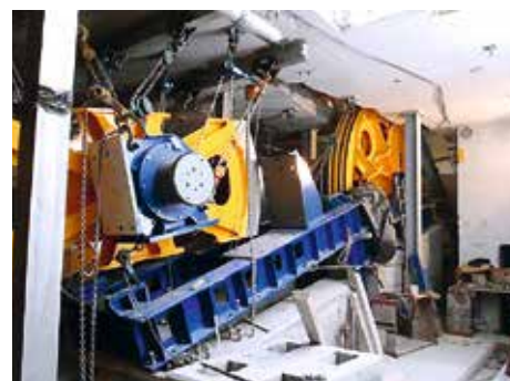
Maschinenraum: Die sichtbaren Teile wiegen zusammen etwa 85 Tonnen.
