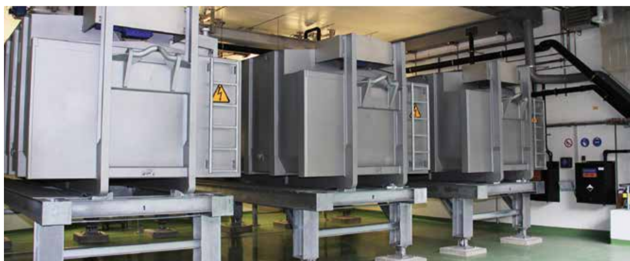
Mulden für Transport des entwässerten Schlammes.
