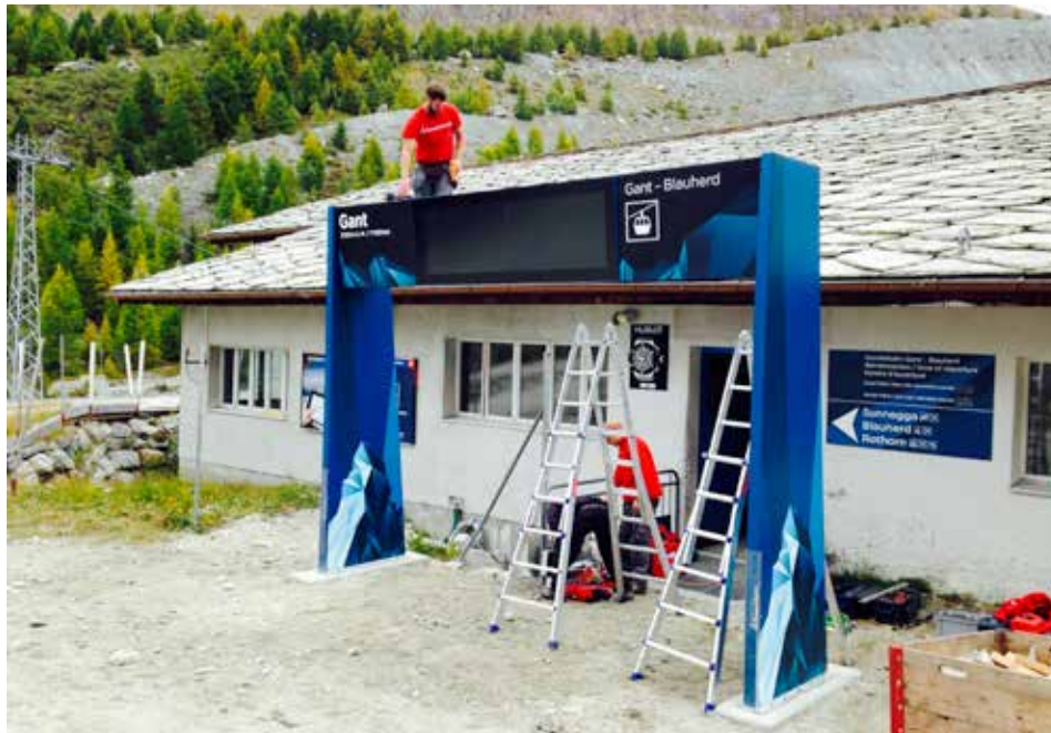
Im Sommer wurden die Gebiete Nord und Mitte mit einem digitalen Informationssystem ausgestattet.
