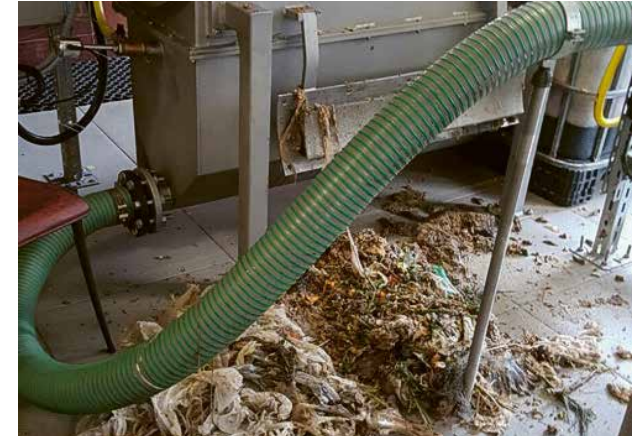
Durch Falschentsorgungen werden die Maschinen verstopft und beschädigt.
