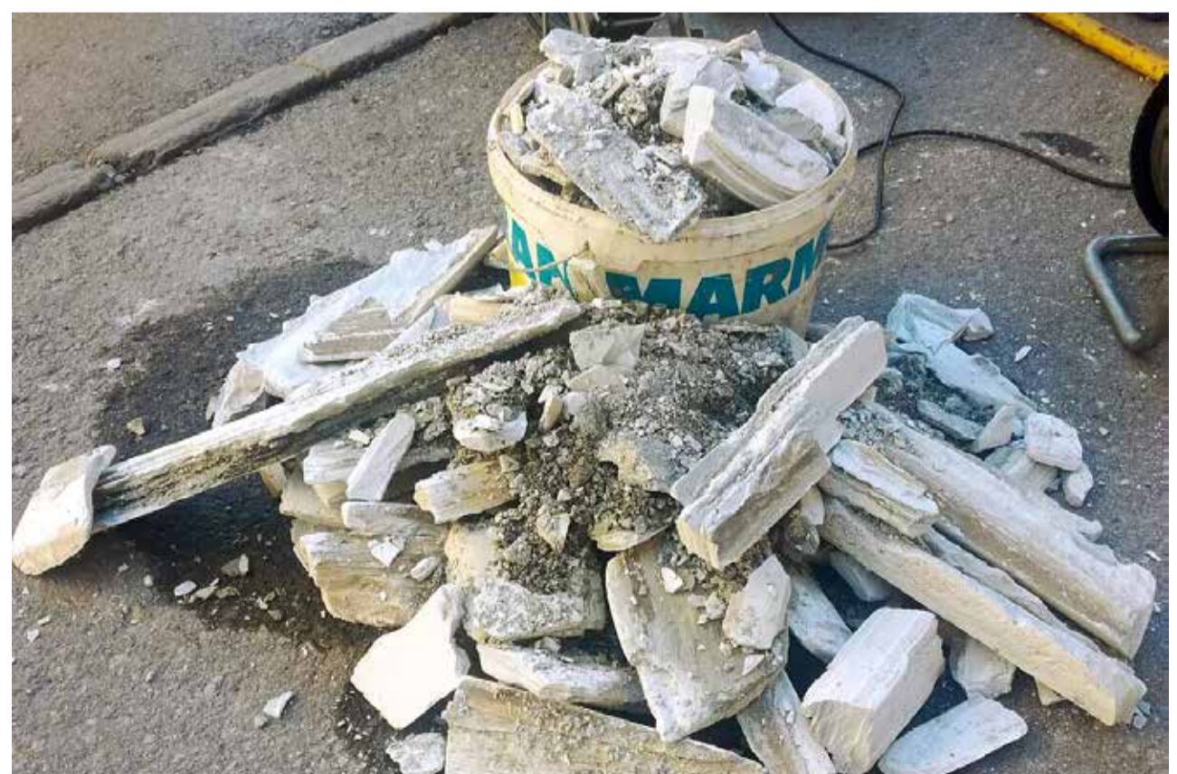
Entnommene Ablagerungen in den Abwasserleitungen, welche durch nicht fachgerechte Entsorgungen entstanden sind.
