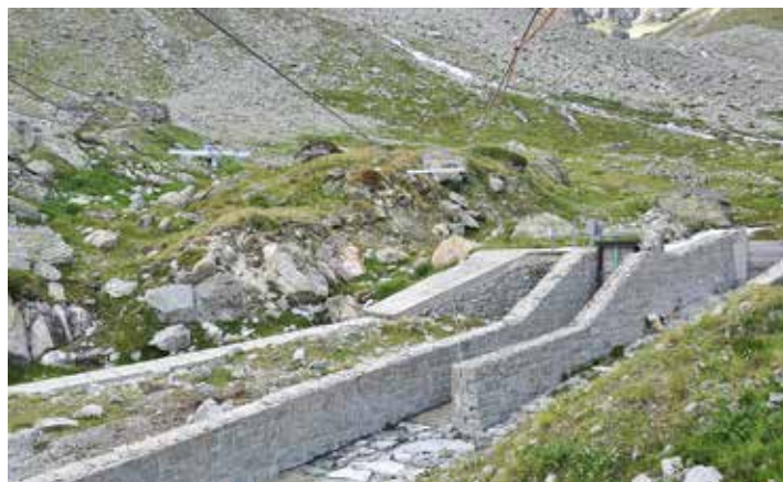
Fassung der Grande Dixence, Triftbach mit Radaranlage
