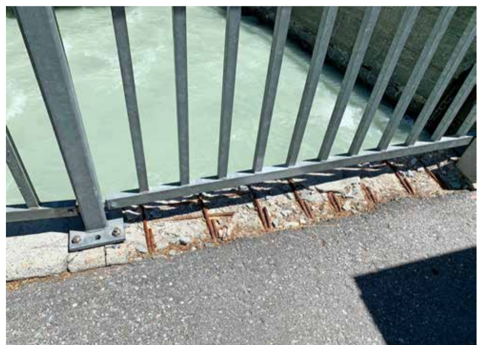
Gravierende Schäden wurden festgestellt.
