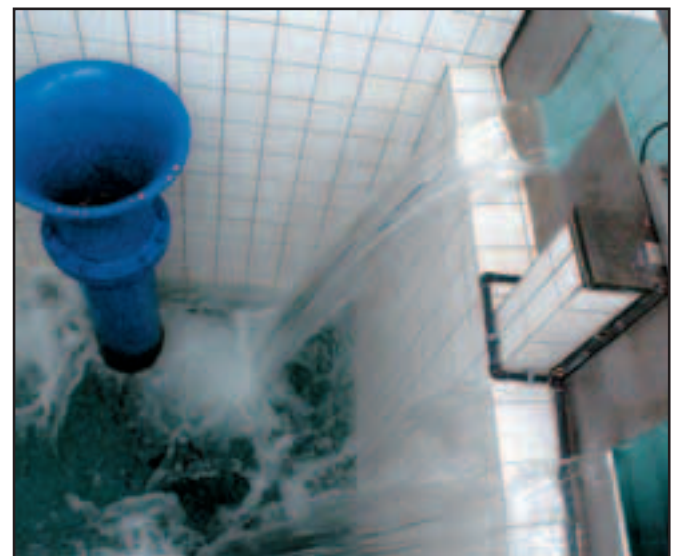
Täglich fließen durchschnittlich 4000 m 3 Quellwasser in das Einlaufbecken des Hauptreservoirs Wichje.
