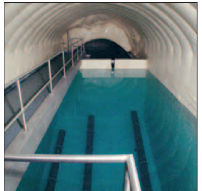
Nicht nur Trinkwasser, sondern auch Löschwasser muss in genügender Menge sichergestellt werden. Im Bild die Löschwasserreserve im Hauptreservoir Wichje.
