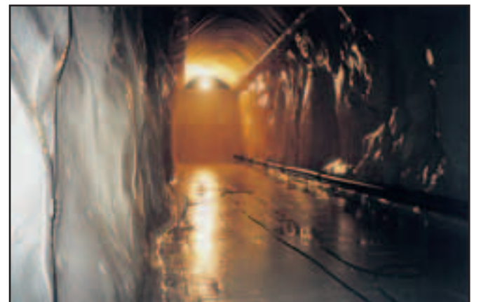
Einmal jährlich werden die Kammern im Stollenreservoir Wichje entleert und gereinigt.
