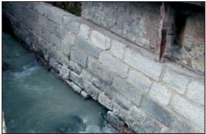
Sogar an Flachstrecken des Triftbaches (hier kurz vor der Einmündung in die Vispa) findet man Unterhöhlungen der Ufermauern.
