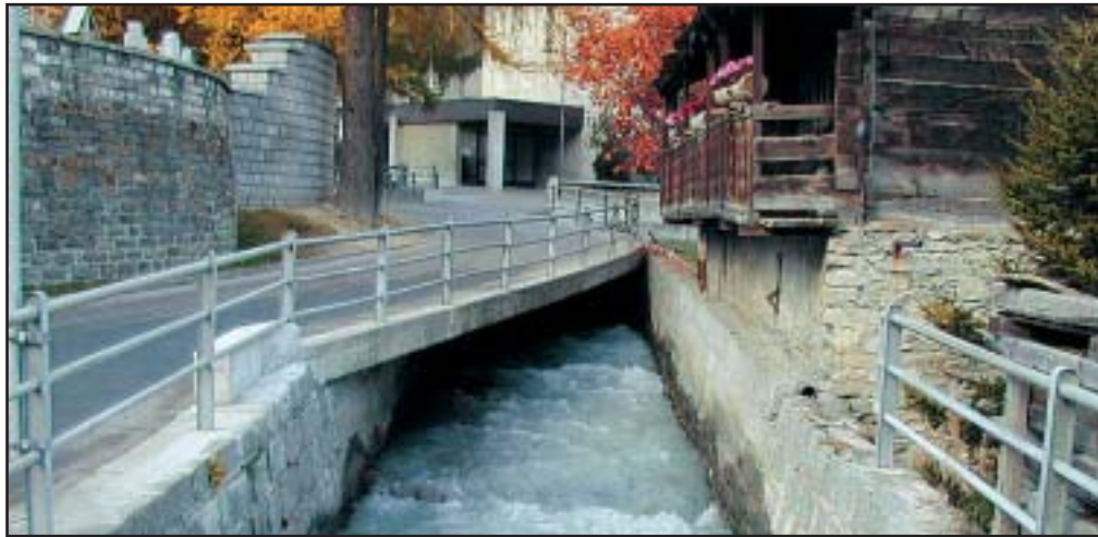
Die engen Platzverhältnisse für die Wasserläufe stellen in Zermatt eine spezielle Situation dar. Im Bild die problematische Überdeckung des Triftbachs bei der Triftbachhalle.
