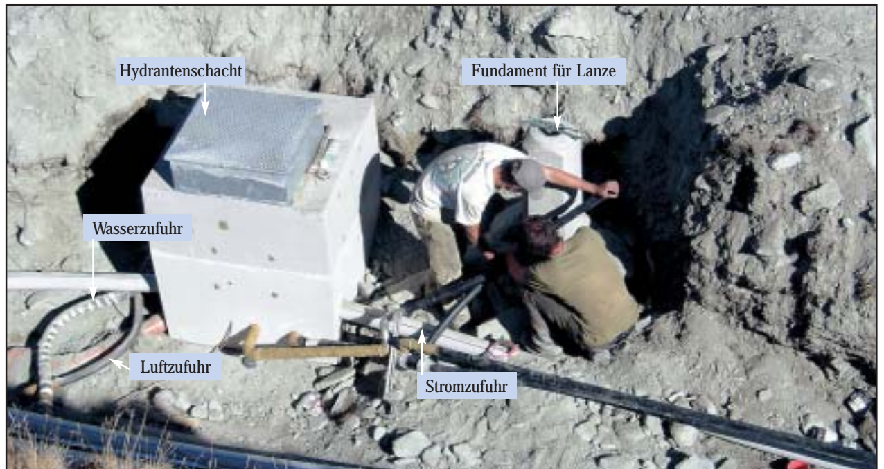
Die Beschneigungsanlage Breitenboden–Rothorn wurde als Lanzenanlage ausgeführt: Dabei wird den Lanzen Wasser und Druckluft zugeführt.
