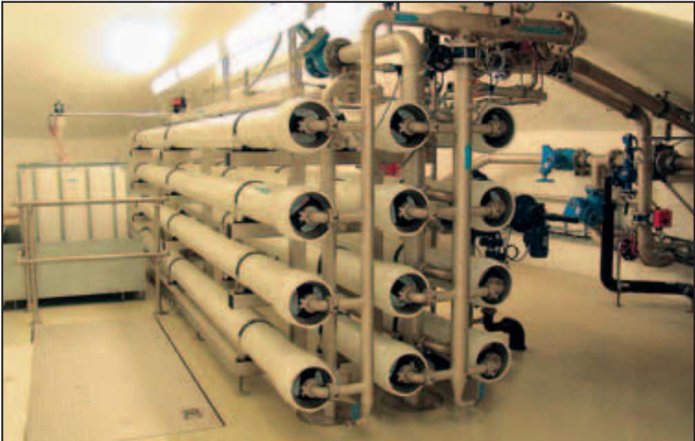
Dank der neuen Filtrationsanlage kann das Gandwasser als Trinkwasser genutzt werden.
