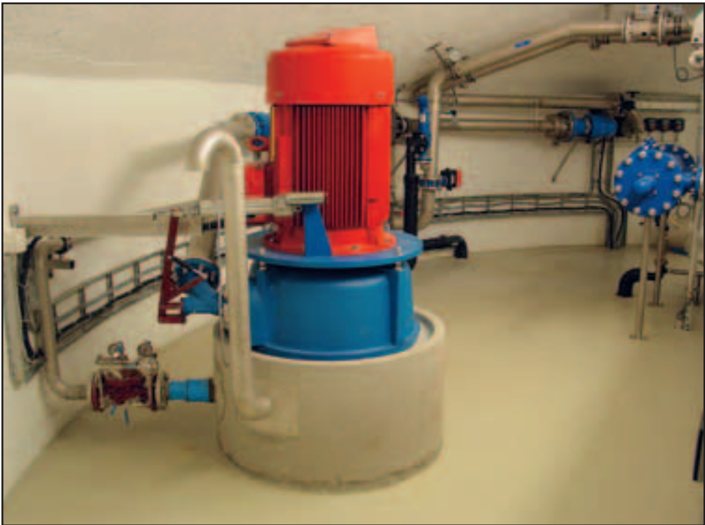
Die neue Turbine in der Filteranlage «Wichje» wird bald in Betrieb genommen.
