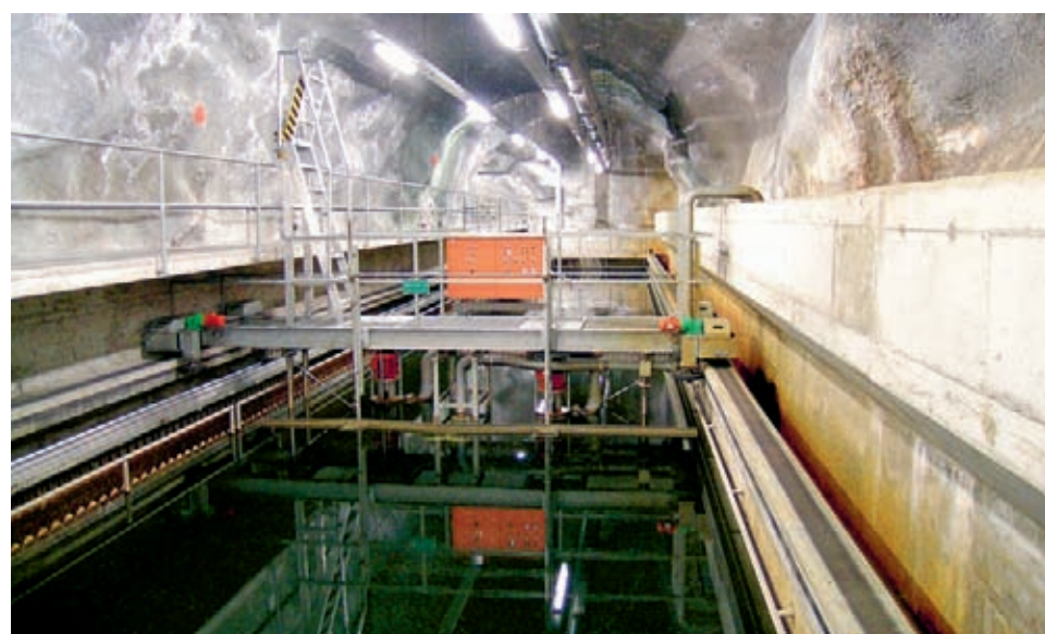
Kläranlage in der Felskaverne.
