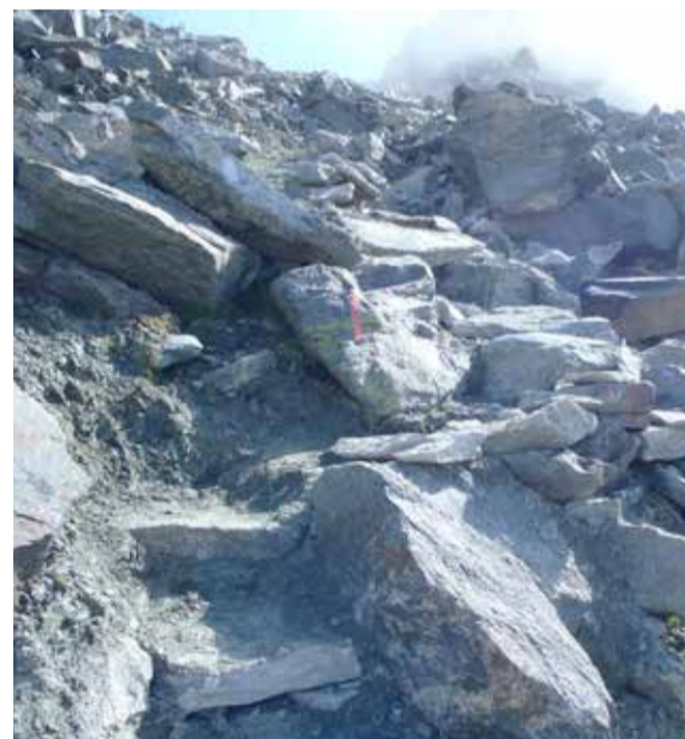
Die Passage Pfulwe wurde von Mitarbeitenden des Technischen Dienstes während mehreren Tagen aufwendig saniert.
