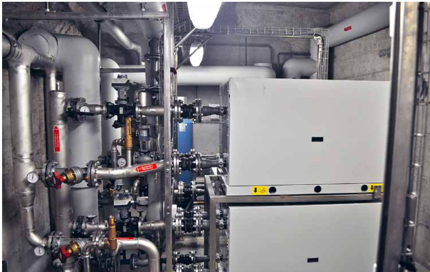
Wärmepumpen und Heizleitungen
