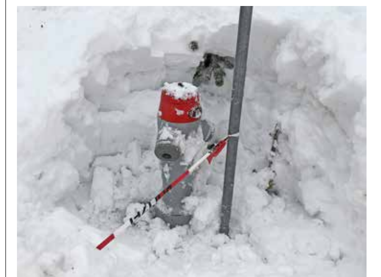
Gemeinderat und Feuerwehrkommando legen Wert darauf, dass die Löschwasserversorgung auch im Winter einwandfrei funktioniert. Wichtig ist in diesem Zusammenhang, dass sämtliche Hydranten zugänglich und von Schnee und Eis befreit sind.
