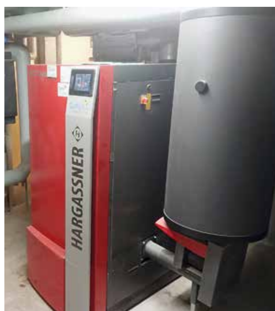
Pelletheizung im Haus Terminus / Zollhaus.
