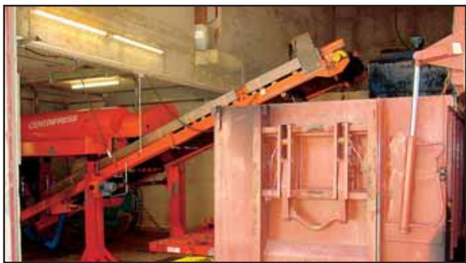
Die Schlammmentwässerungsanlagen müssen erneuert werden.
