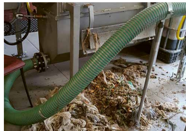
Durch Falschentsorgungen werden die Maschinen verstopft und beschädigt.
